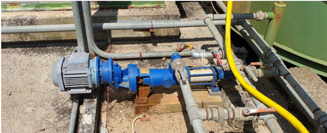
Figura 12. Elettropompe tipo monovite di estrazione fanghi dagli stabilizzatori
