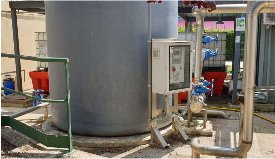
Figura 9. Accumulo acqua controlavaggio
