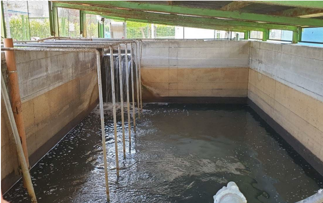
Figura 2. Vasca di accumulo ed equalizzazione attuale.
