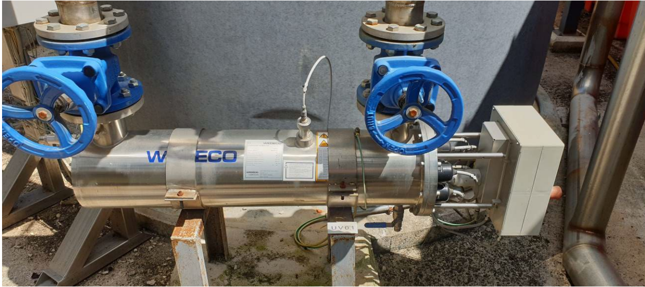
Figura 8. Debatterizzatore a radiazioni UV-C
