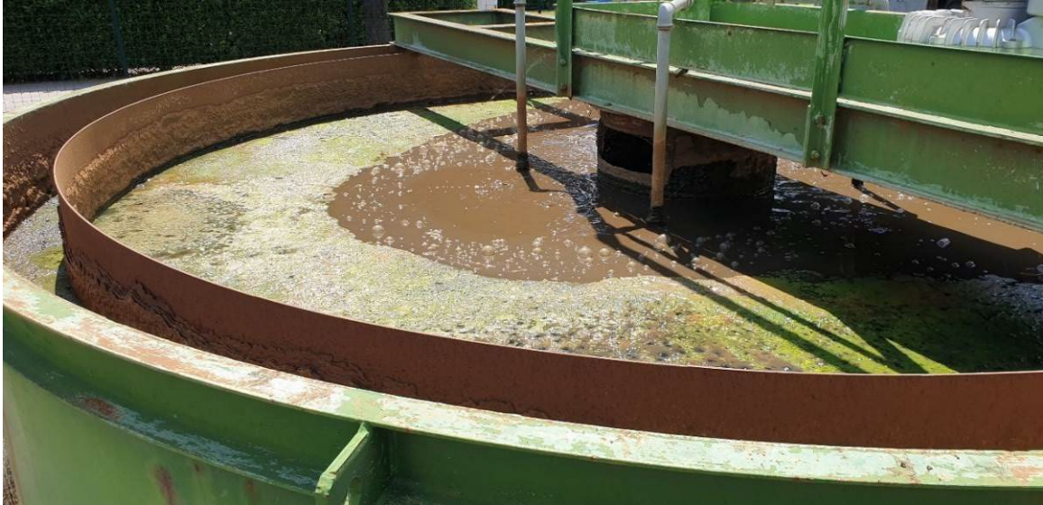
Figura 11. Bacini stabilizzazione fanghi
