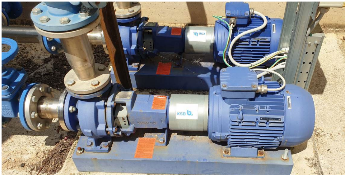
Figura 10. Pompe di rilancio acqua
