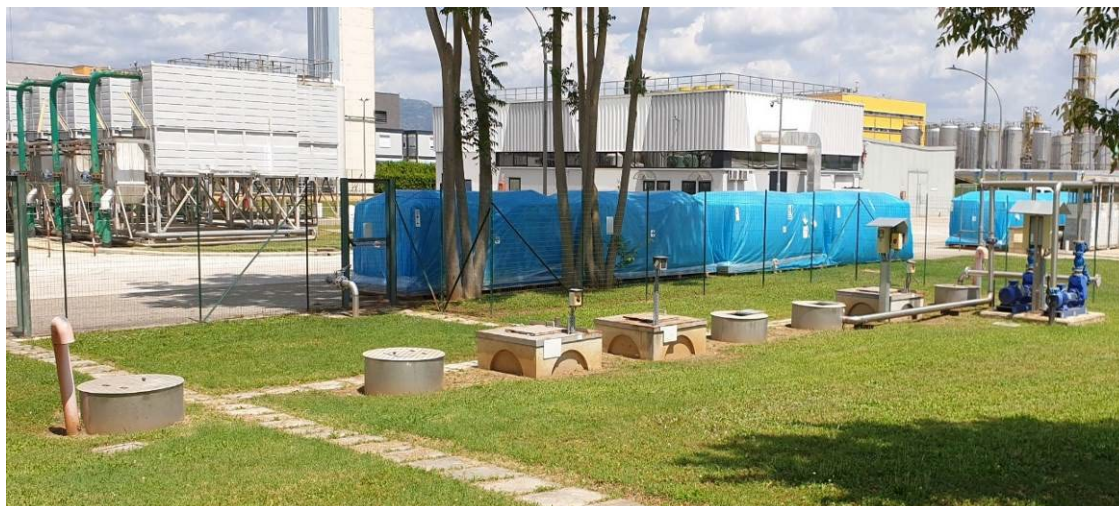
Figura 5. Serbatoio di accumulo interrato
