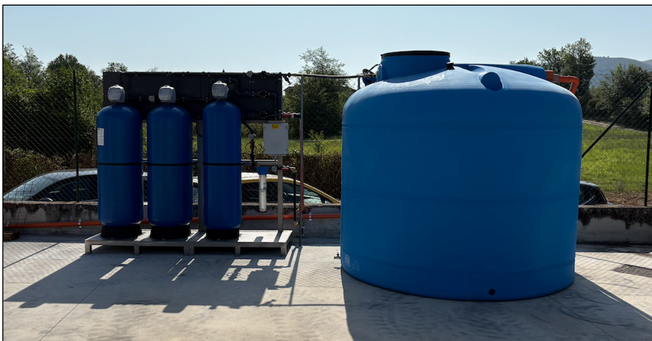
Foto: Skid di filtrazione + serbatoio esterno da 10.000 litri
