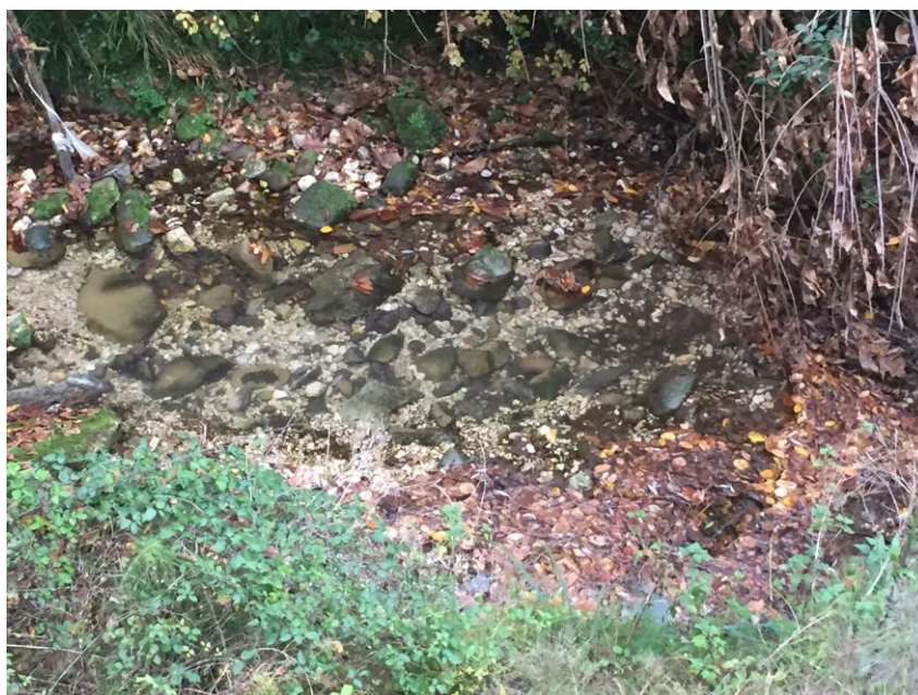
Foto n.1 (Sopralluogo del 30/10/2024- alveo con acqua)
