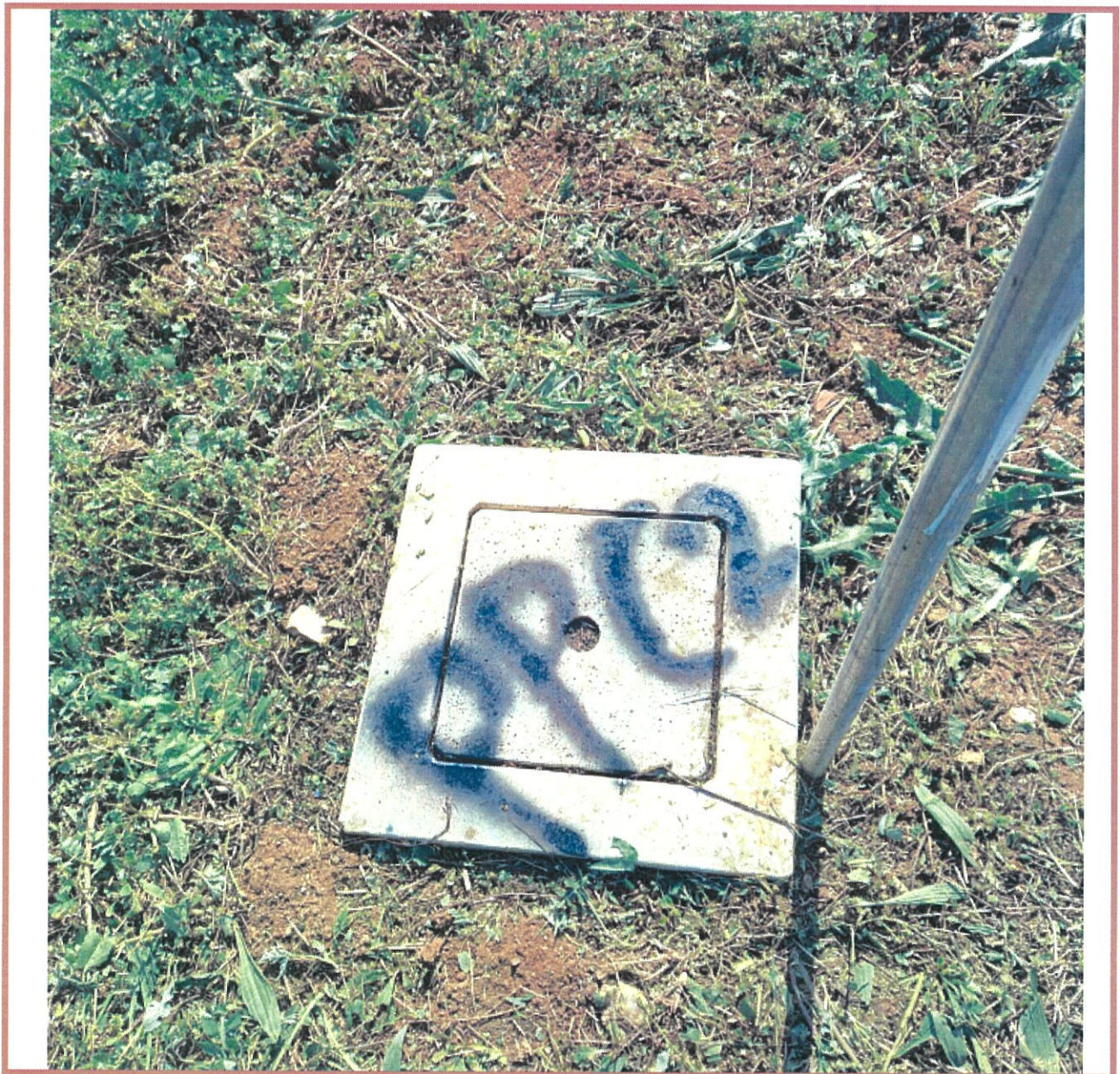
pozzetto di ispezione e di campionamento PPC2 acque di seconda pioggia pioggia
