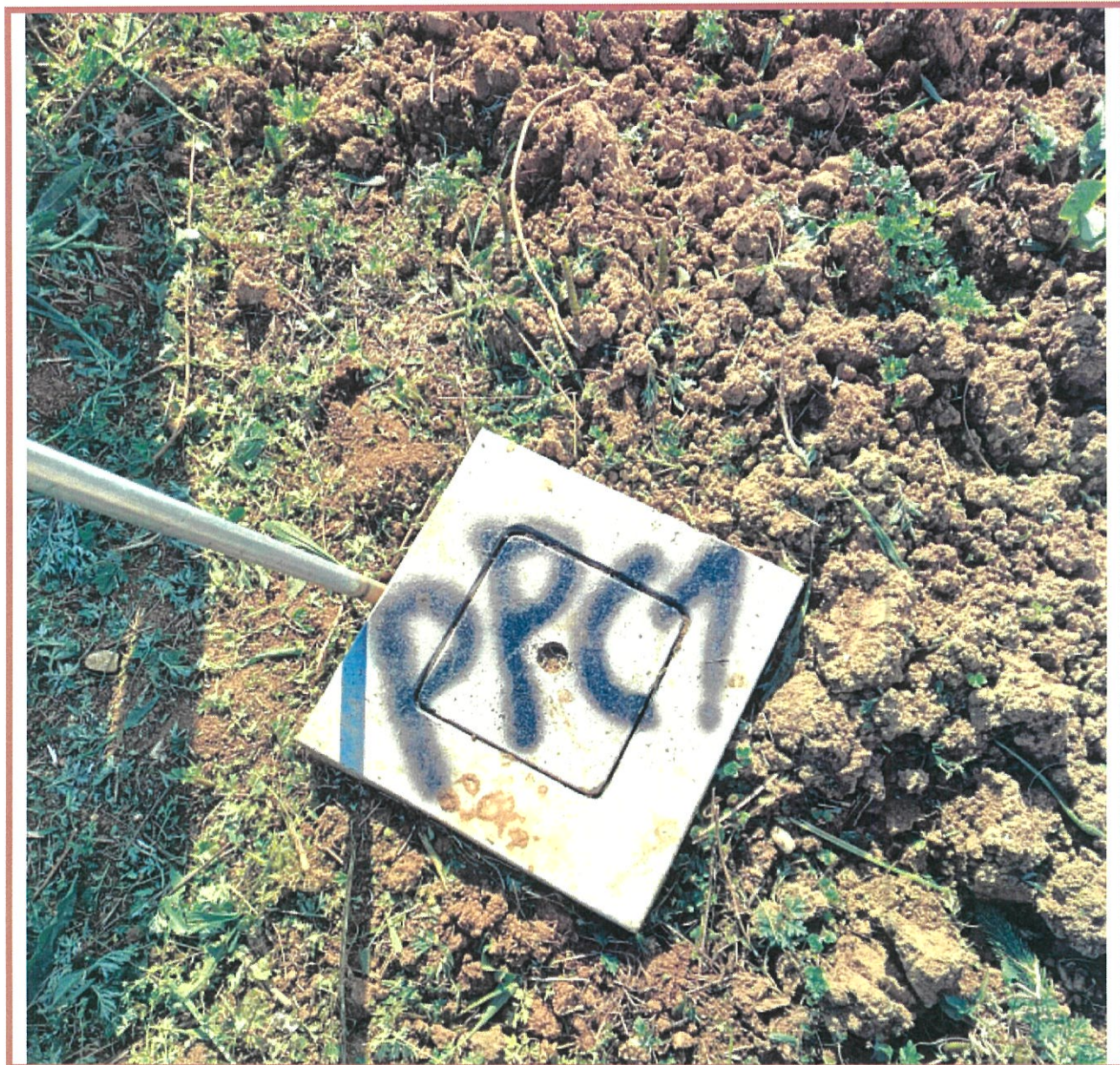
pozzetto di ispezione e di campionamento PPC1 acque di prima pioggia
